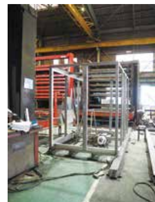
工場内の様子 (納品前の空調機ユニットの骨格)
