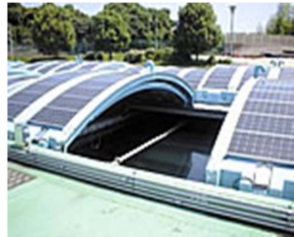
写真7 小雀浄水場の太陽光発電設備
