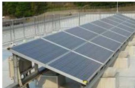
菊名ウォータープラザの太陽光発電設備
