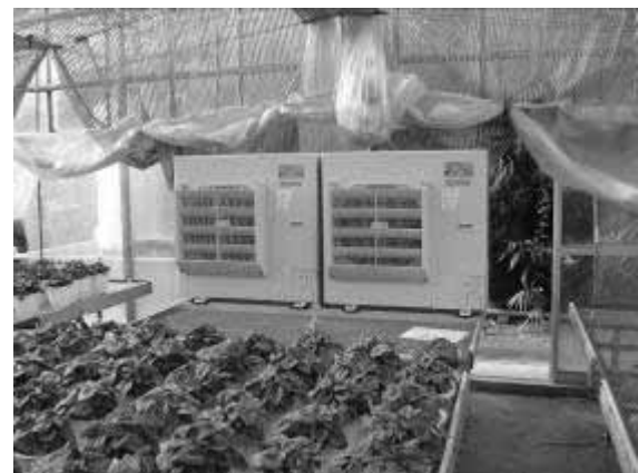
【写真】ヒートポンプを設置した温室
