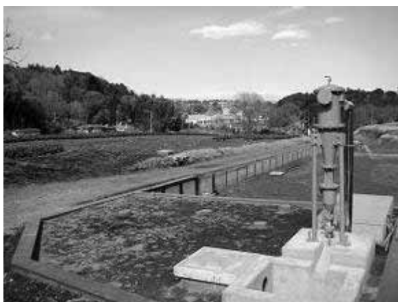
【写真】井戸及び配管整備 (緑区、向原地区畑地かんがい組合)
