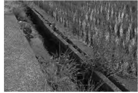
老朽化した用水路
