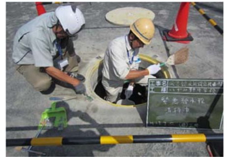
横浜市管工事協同組合による保守点検
