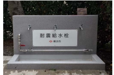
新吉田小学校へ設置された「耐震給水栓」
