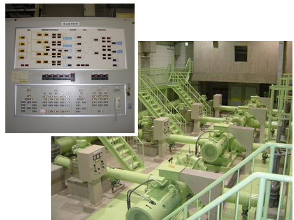
配水池のポンプ設備類
