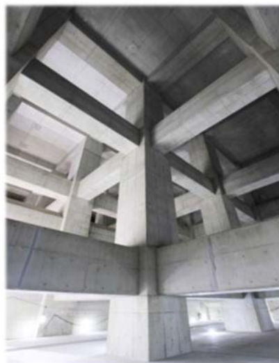
公園の地下に設置された雨水調整池
