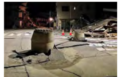
写真1 マンホール浮上（輪島市）
