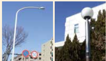
2種類の道路照明灯
